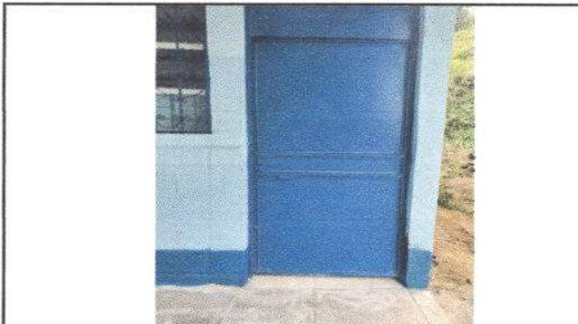
Foto 3: MANTENIMIENTO A ESTRUCTURAS (LIJADO, SUGECIONES, Y APLICACIÓN DE PINTURA) 4 PUERTAS DE TES AULAS Y DIRECCIÓN
